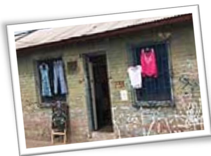
La sede que nos entregaron en el 2017 estaba abandonada hace muchos años. El techo se llovía, la instalación eléctrica era muy peligrosa y –como puede apreciarse en la foto– necesitaba ser pintada íntegramente.
